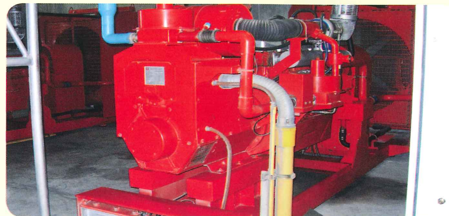
Janakuasa (Generator) Yang Menghasilkan Tenaga Elektrik Daripada Biogas
